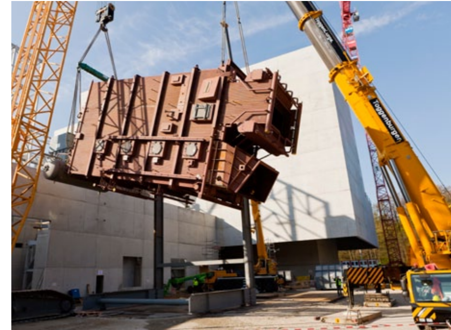
Schwergewicht: Zwei Spezialkrane heben den 230 Tonnen schweren Kessel des Holzheizkraftwerks in der Energiezentrale an seinen Platz.
